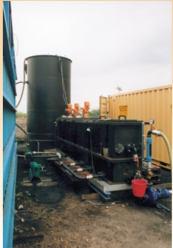
Teil der Pilotanlage für die Grundwasserreinigung auf dem Gelände der Kokerei Lauchhammer, 2001
