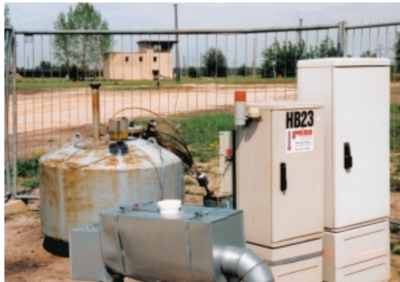
Grundwasserhaltungsbrunnen mit Produktphasenabschöpfung (flüssige Teeröle im Grundwasser) auf dem Werksgelände Schwarze Pumpe, 1999
