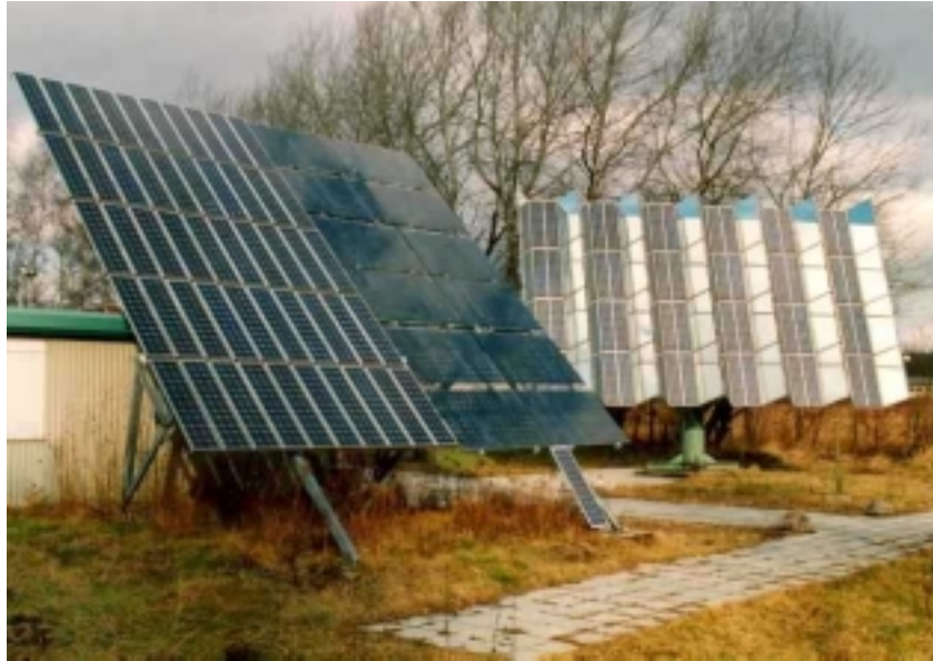
Abb. 1: Solaranlage der Universität Potsdam
