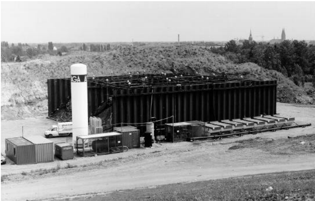
Abb. 2 Eingehauste, gekapselte Biologische Stabilisierung mit vollständiger Gasbehandlung zur nachfolgenden Stofftrennung, hier: Testausführung ohne Dach und Tore
