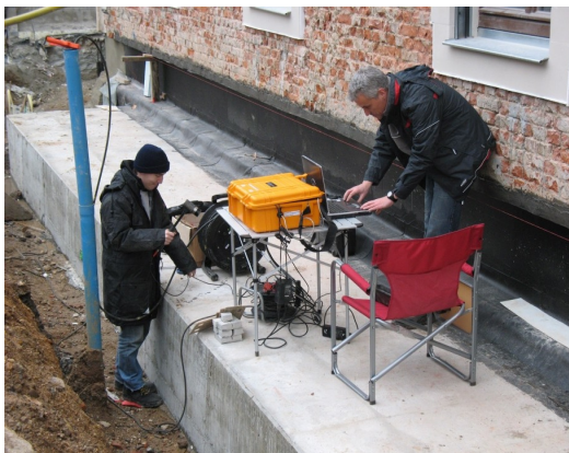
Abbildung E.12: Parallel-Seismik Messungen in Grimma auf dem Kopfbalken über der Pfahlwand (Dezember 2008).
