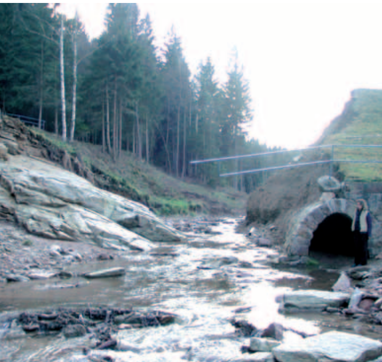
Bruch in einem Hochwasserrückhaltebecken oberhalb von Glashütte, 2002.
