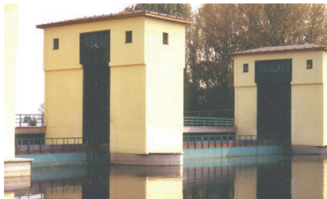
Abb. 3-13: Wehr Neuwerben nach dem Augushochwasser 2002 mit auf den Schützen aufgesetzten Blechen (Foto: LUA)
