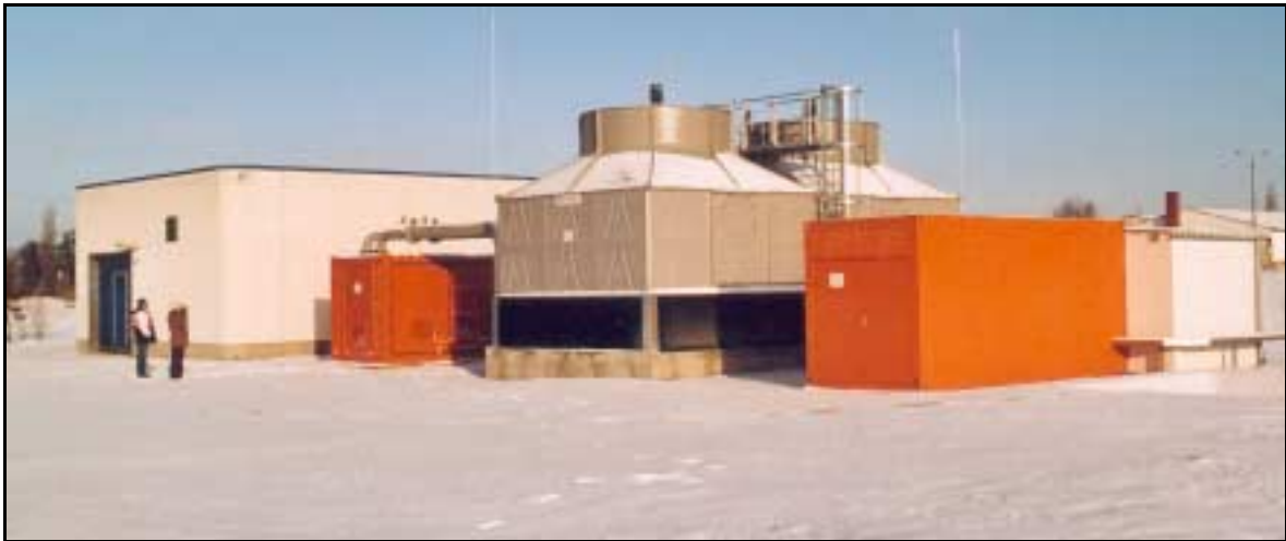
Abbildung 13: ORC-Anlage und Kühltürme des hydrothermalen Kraftwerkes in Neustadt-Glewe (eigene Aufnahme)
