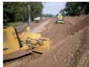
3 Neubau der Abwasserleitung bei Deich-km 8+943 in der Neuzeller Niederung, Baulos 52 a (Fotos: R. Kahlisch)
