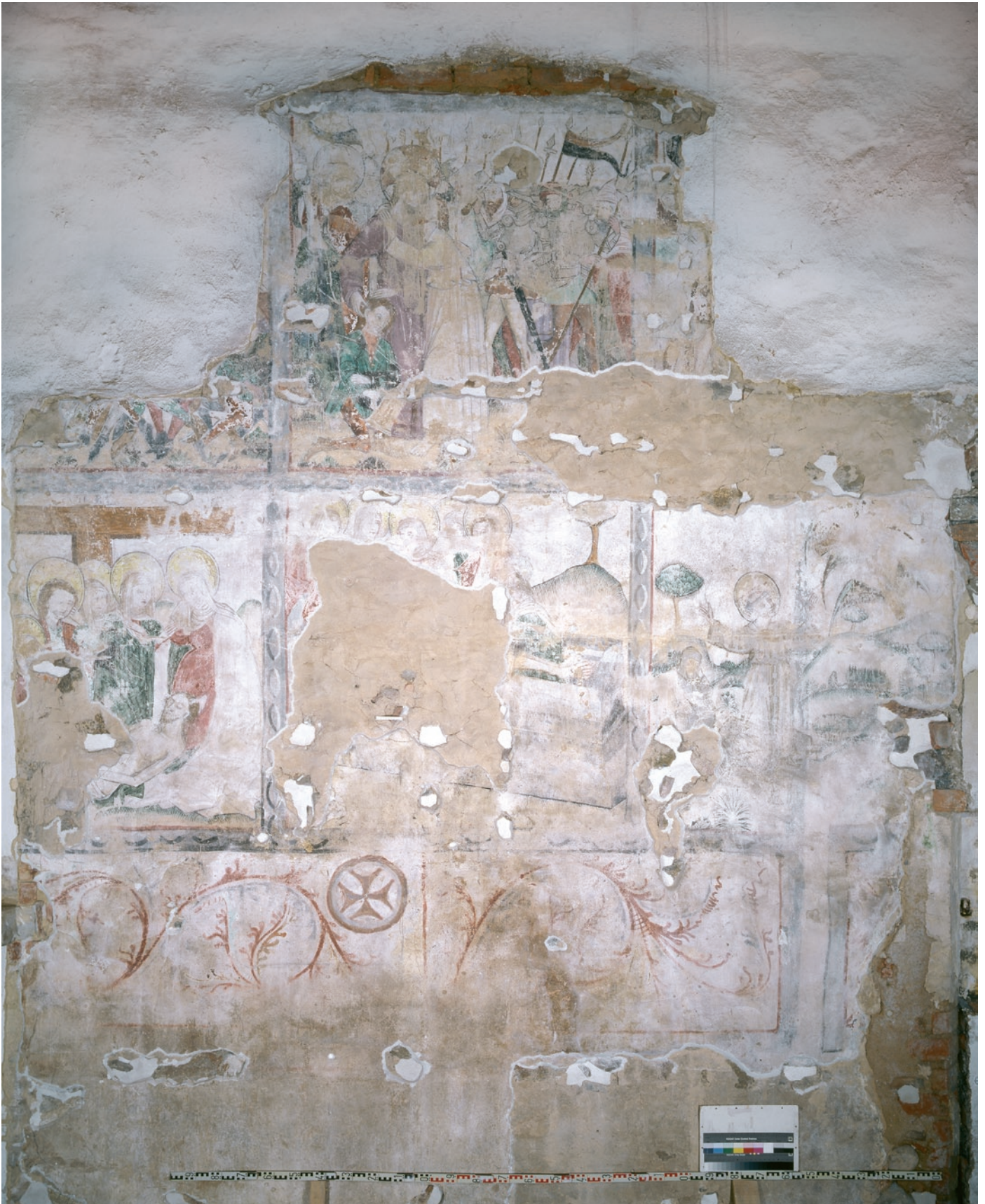
Beesdau (LDS), Kirche, Wandmalerei. Die mittelalterliche Freskenmalerei an der Nordwand ist 2001 bei Abnahme eines Steinepitaphs zum Vorschein gekommen. Sie wurde gesichert, von der Hauptszene eine Kopie angefertigt. Inzwischen verstellt das restaurierte Epitaph wieder den Blick auf die Malerei.
