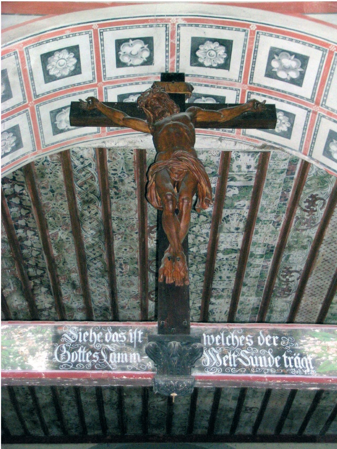
Wusterwitz (PM), Deckenmalerei in der Kirche. Von besonderem Wert ist die im Chor der Kirche erhaltene spätgotische, bemalte Holzdecke. Die mit mehrfarbigen Motiven reich gemusterte Schablonenmalerei stammt aus dem Ende des 15. Jahrhunderts. Nach der Sanierung des Dachstuhls erfolgte 2005 die Konservierung der Deckenmalerei.
