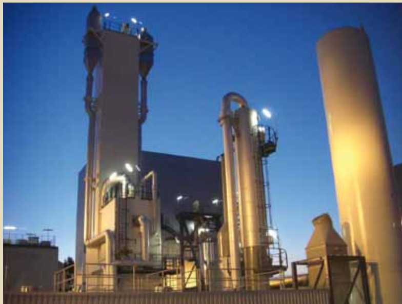
Weltweit erste Pilotanlage für ein CO 2 -armes Kraftwerk: Gebaut im Auftrag des Kooperationspartners Uni Cottbus.
