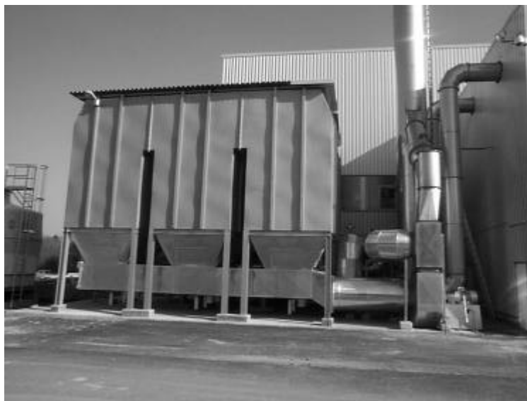
Abb. 3 Abluftreinigung LARA der Trockenstabilat®-Anlage Rennerod
