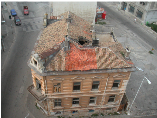
Foto 23: Constanţa – teilweise noch bewohntes Haus
